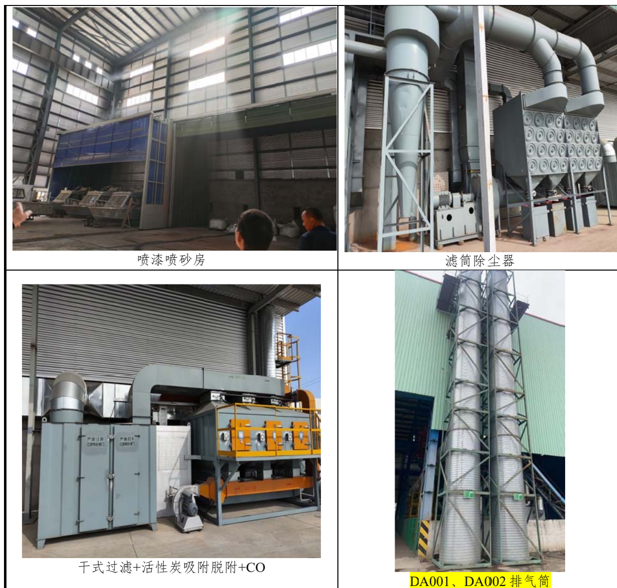
图 3.6-1 现有项目废气处理设施
